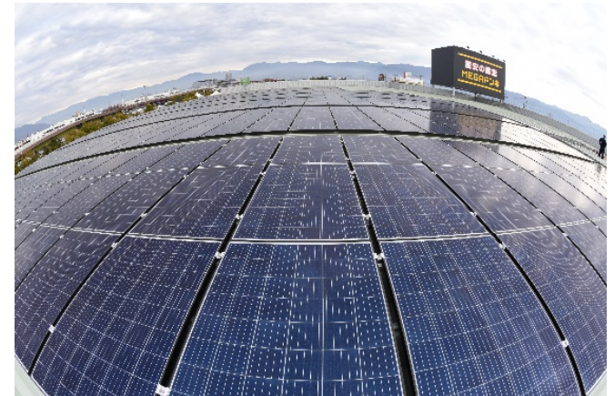
太陽光パネル（MEGAドン・キホーテ甲府店）
